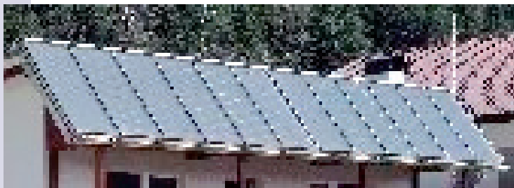
particolare collettori solari
