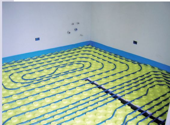
particolare pannelli radianti
