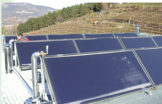
particolare collettori solari
