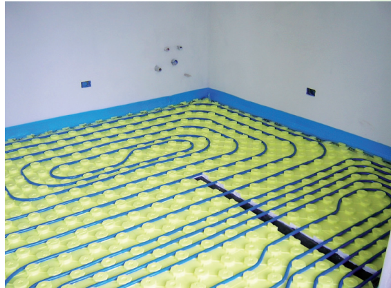
particolare pannelli radianti a pavimento
