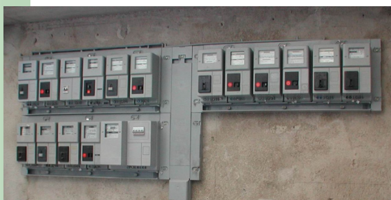
particolare contatori energia elettrica
