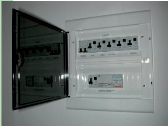
particolare quadro elettrico
