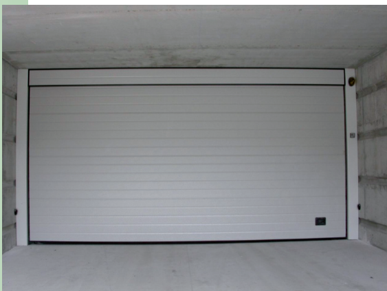
portone sezionale motorizzato accesso autorimessa
