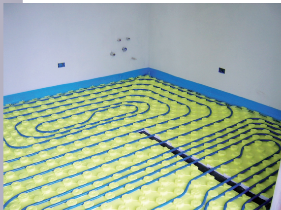
particolare pannelli radianti a pavimento
