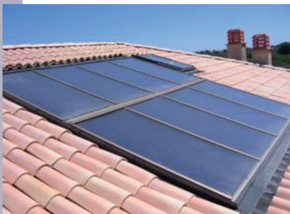
particolare collettori solari termici
